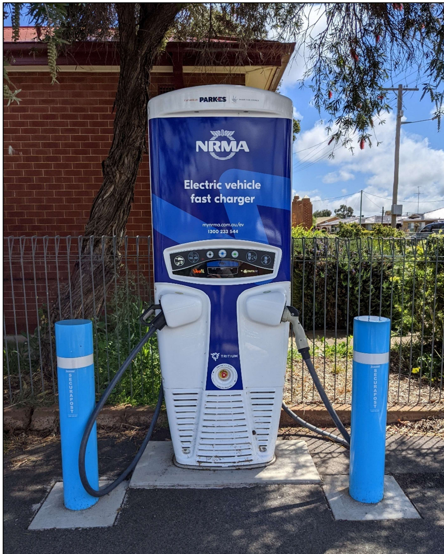
Parkes - NRMA 50kW EVSE
